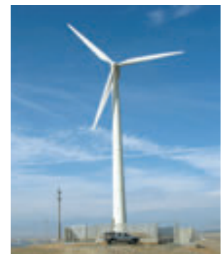
Aerogenerador en Marcona, Ica.
