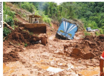
Efectos de una lloclla en una carretera de la Amazonía.
