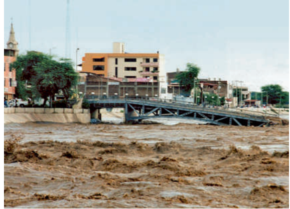
Puente colapsa en Piura tras las lluvias causadas por El Niño de 1998.
